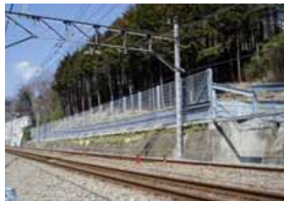
土砂止め柵 [ 自然斜面 ]
