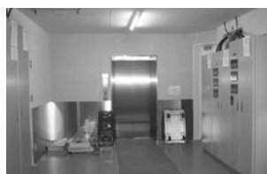
物流用エレベーター
