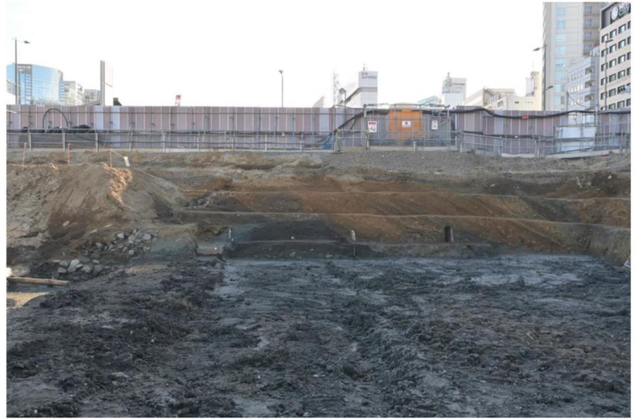
I 区南壁築堤横断面
