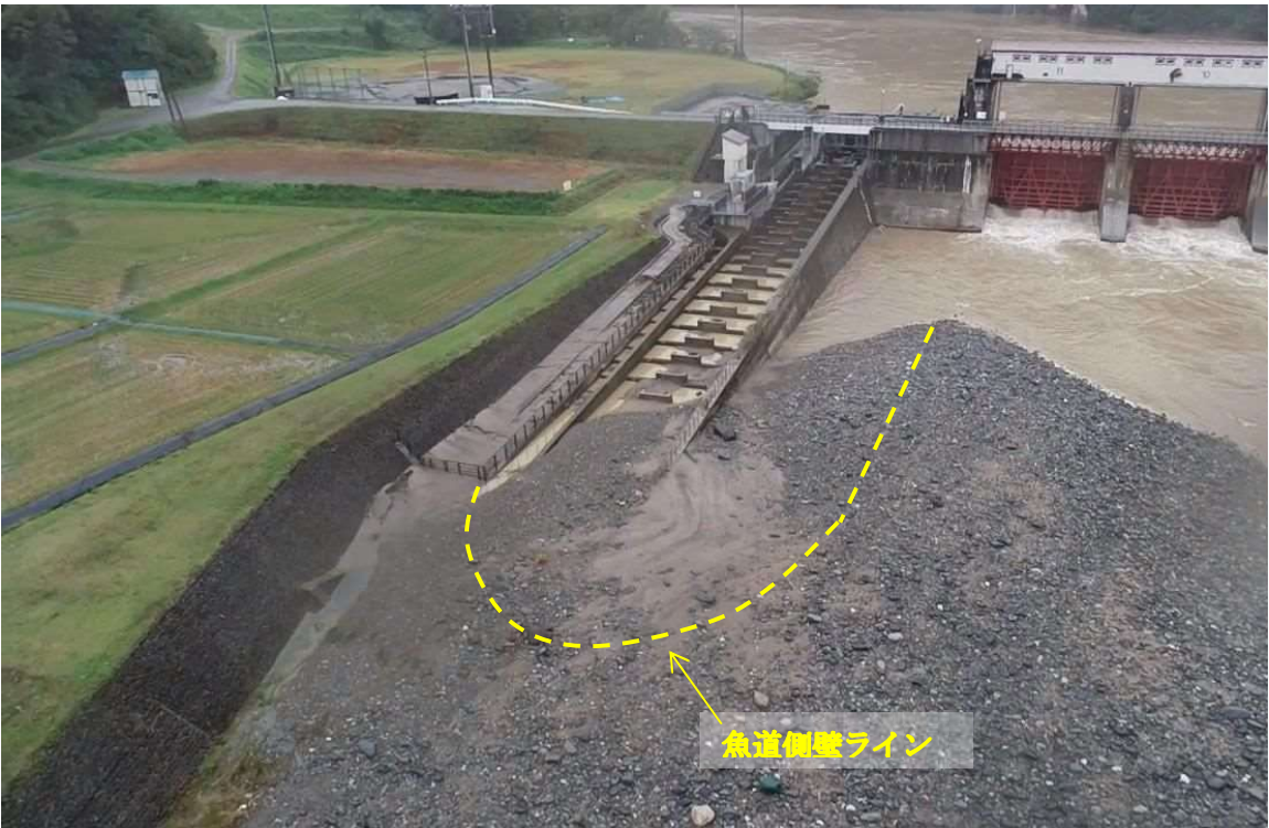
図1.2 魚道の土砂堆積状況全景（2019年10月15日）
