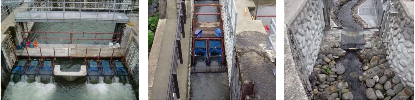
写真 3.1.1 捕獲カゴの設置の状況 (左: 大型魚道 中央: 小型魚道 右: せせらぎ魚道)
