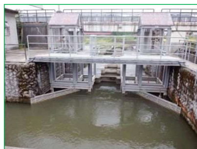
トラップ設置状況(上流方より)
