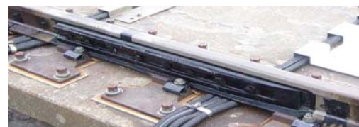
改良後の接着絶縁継目
