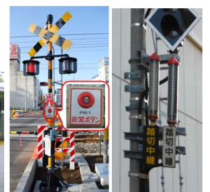
(非常ボタン)(特殊信号発光機) 踏切支障報知装置
