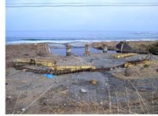
A【橋げた流失】 しゆのへ りくちゅうやぎ (八戸線 宿戸～陸中八木)
