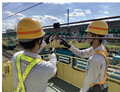
保守用車作業台での 電力設備の保守体験
