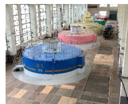
発電機設備見学
