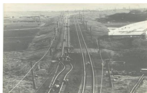
高温時のレール張り出し現象 (1978年5月 東北本線 栗橋～古河駅間)
