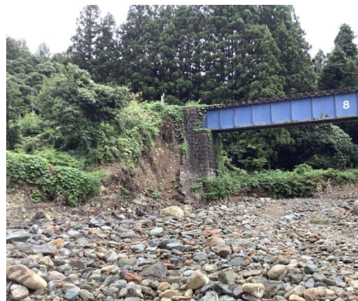
鵜杉～瀬見温泉間 河川脇盛土崩壊箇所
