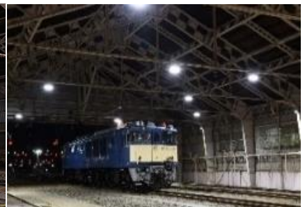
庫内照明（夜間）
