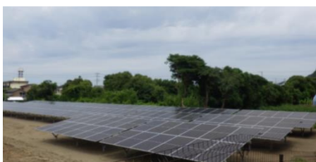
ペリエ太陽光発電所館山那古
