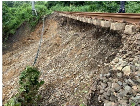
真室川～釜淵駅間 盛土のり面崩壊
