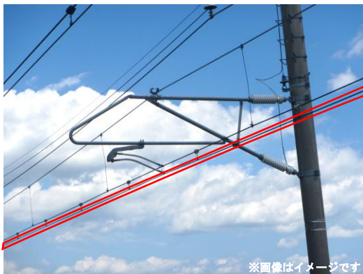
東北新幹線 トロリ線（赤枠部）
