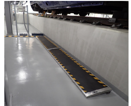
ホーム下設備
