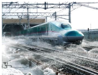
【散水消雪設備】
