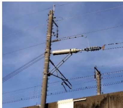
新幹線電車線（架線）設備
