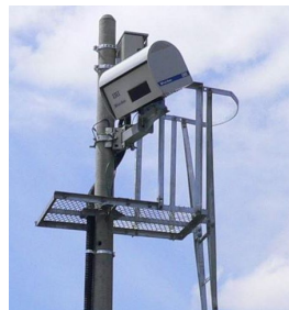
障害物検知装置
