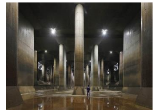
首都圏外郭放水路(イメージ) 写真提供：(一社)埼玉県物産観光協会
