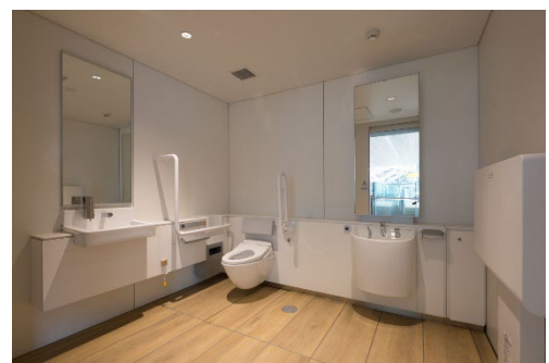
バリアフリートイレの整備
