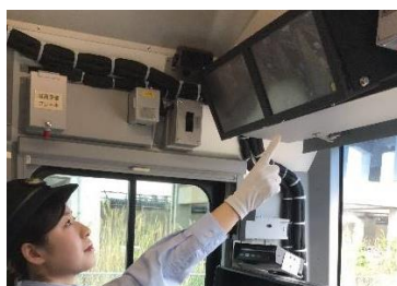
ワンマン運転設備
