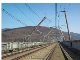
仙台～古川間電化柱折損
