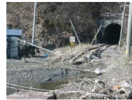
東塩釜～陸前浜田間 道床・線路流出
