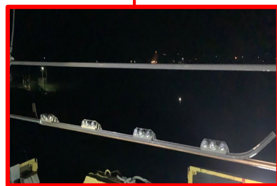
架線断線の仮復旧箇所
