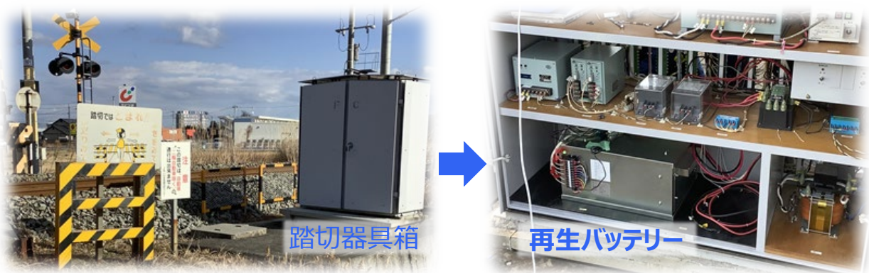
〔再生バッテリーの設置状況〕
