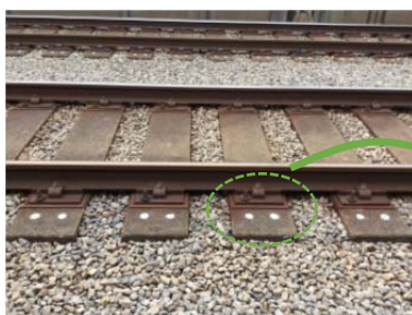
写真1 弾性まくらぎ直結軌道
