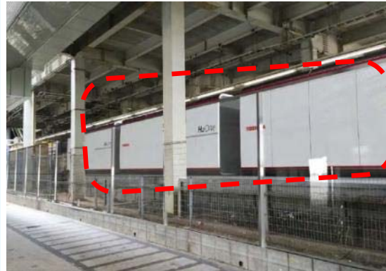
(北口駅前広場側) 自立型水素エネルギー供給システム導入
