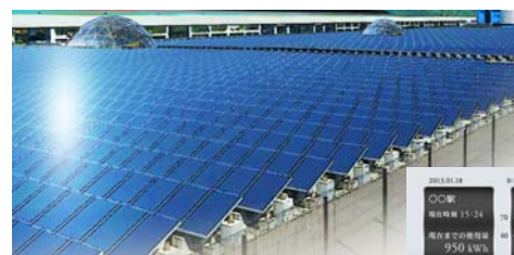
太陽光発電設備
