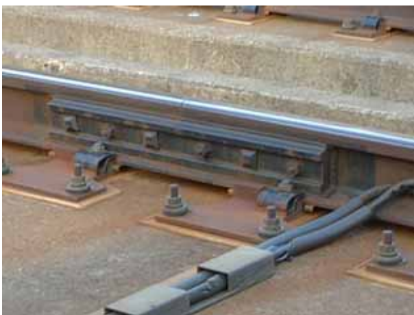
現行IJの敷設状況
