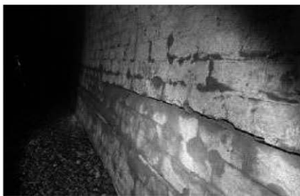
図2 変状（目地切れ）の例
