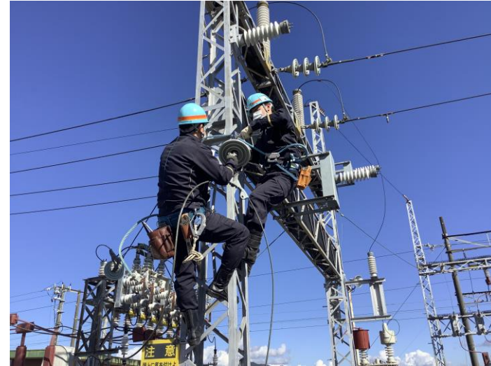
電気設備の保守点検
