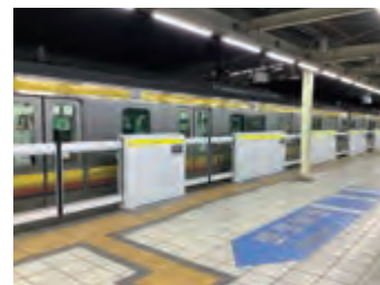
ホームドア (南武線武蔵小杉駅)
