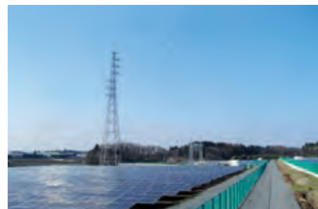
市貝太陽光発電所
