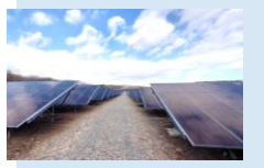
栃木県池田太陽光発電所
