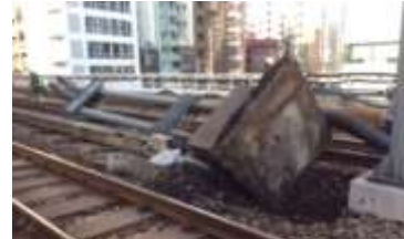
山手線神田～秋葉原間電化柱倒壊
