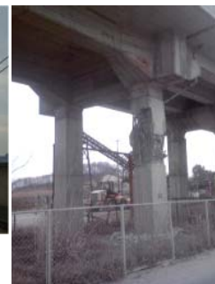
【高架橋柱の損傷】
