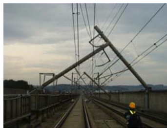
【電化柱の折損】
