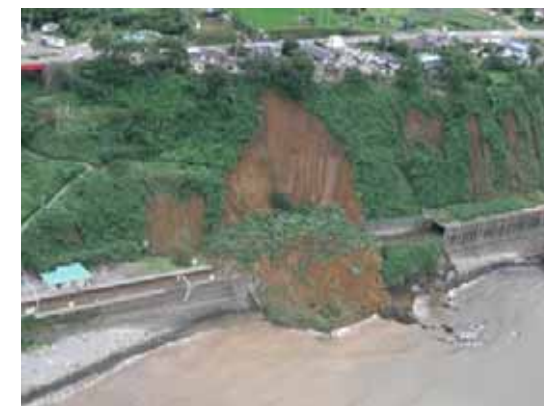
【信越線 青海川駅構内】
