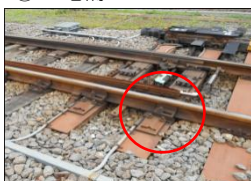
枕木とレールの間の床板が温まる仕組みの電気融雪器
