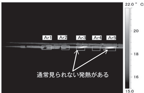
図3 劣化した圧縮接続部のサーモカメラ画像
