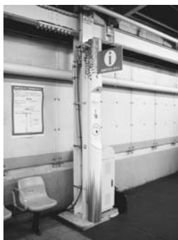
図8 端末設置状況
