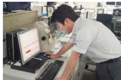
指令室の保守作業確認端末
