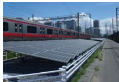
京葉車両センターに設置された太陽光発電パネル
