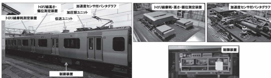
図1 E235系量産先行車 電力設備モニタリング装置(3号車)
