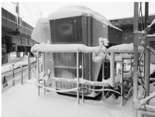
図3 金巻消雪基地 ヒートポンプシステム
