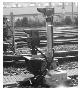
図9 入換信号機と信号附属機の設置状況
