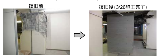
13.【高架橋柱の損傷(郡山駅事務所内)】
