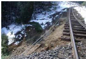
ク.【盛土流失(仙山線 作並～八ツ森間) 復旧前
