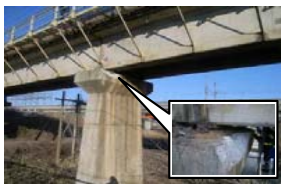
イ.【橋桁支根部損傷(東北本線 福島～東福島間) 復旧前
