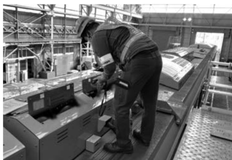
図2 日常点検の実施（水素貯蔵ユニット・水素配管等に対するガス検知器を用いた漏気検査）
