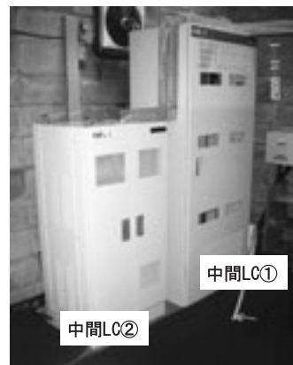
図12 中間LC（機器室）
