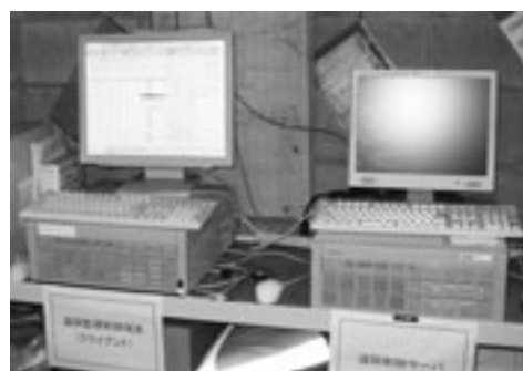
図9 遠隔監視制御端末（左）と遠隔制御サーバ（右）
