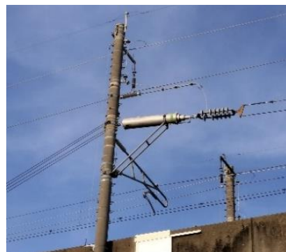
新幹線電車線（架線）設備
