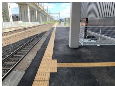
視覚障害者誘導用ブロック
