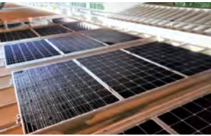
千駄ヶ谷駅 （太陽光発電設備による創エネ）
