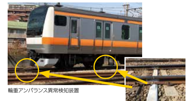
輪重アンバランス異常検知装置
