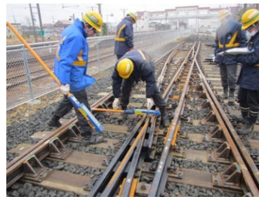
技能教習所の線路設備
