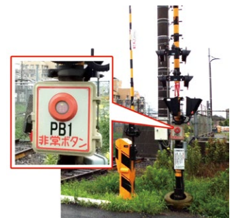
踏切支障報知装置
